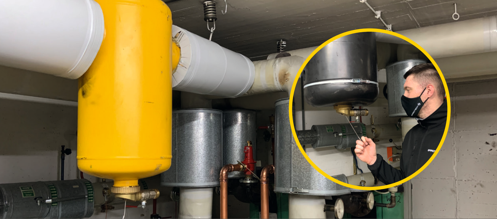
Der noch ungedämmte SpiroTrap in DN 125 ist als Flanschausführung in den Rücklauf eingebunden – Almir Hamzic, Spirotech, zeigt die einfache Bedienung des Drypockets am SpiroTrap
