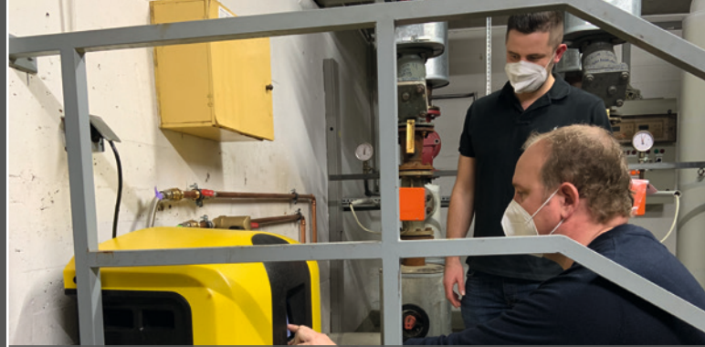
Einweisung und Inbetriebnahme des Vakuumentgasers durch Christian Breul (Fa. Spirotech) und Michael Mika (Fa. TSP)
