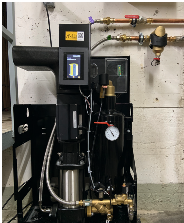
Die Technik des Vakuumentgasers SpiroVent Superior S600 unter der Schutzhülle und im Zulauf ein MB3 Schlammabscheider
