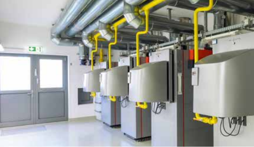
Die Wärmeversorgung der Verdichterstation Krummhörn, eine Kaskade aus vier Gasbrennwertkesseln mit jeweils 450 kW.
