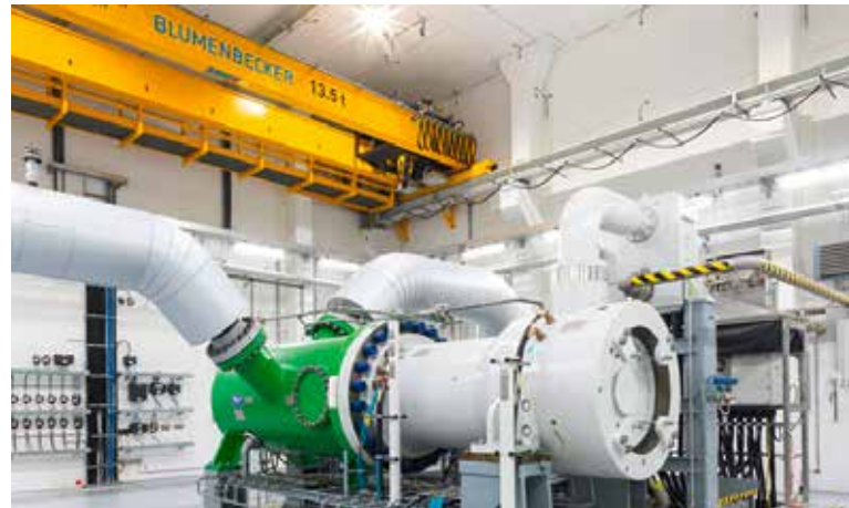
Der mit einem Elektromotor angetriebene Verdichter vom Typ ICL hat eine Leistung von 13,6 MW und wird überwiegend mit Windenergie betrieben – ein Beispiel für eine intelligente Sektorenkopplung. Bildquelle: Open Grid Europe GmbH, Essen
